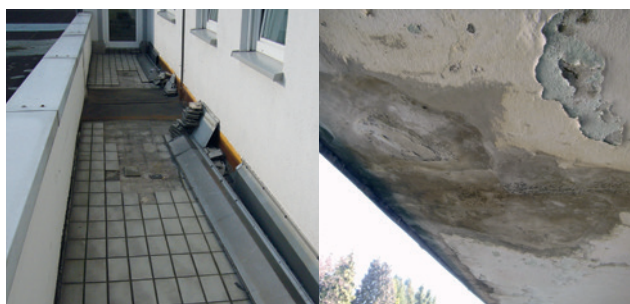
Недостаточная гидроизоляция балкона приводит к массивным повреждениям.
